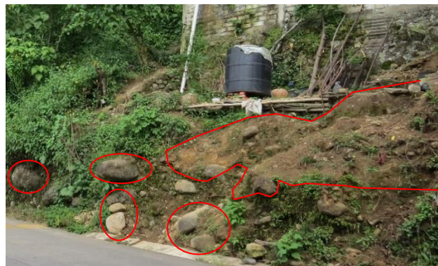
Bloques que se pueden desprender.
