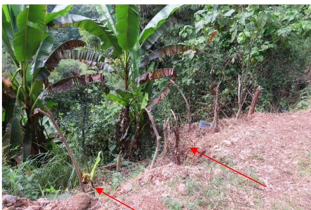
Zona donde se observa que ha habido deslizamiento de suelo.
