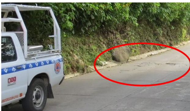
Afectación en el pavimento por posible filtración de agua que baja del cerro.
